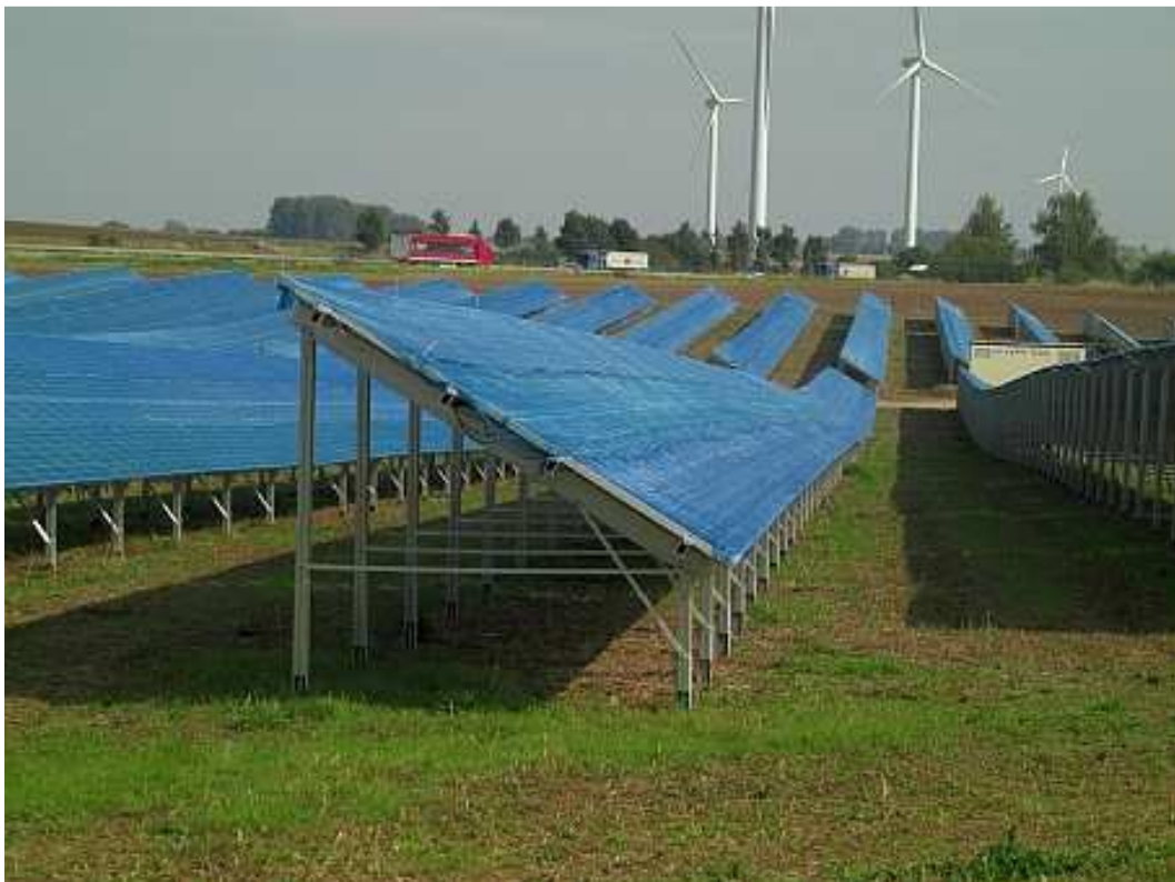
wegen Blendwirkung abgedeckte Module einer PV-Anlage an der Autobahn A14
